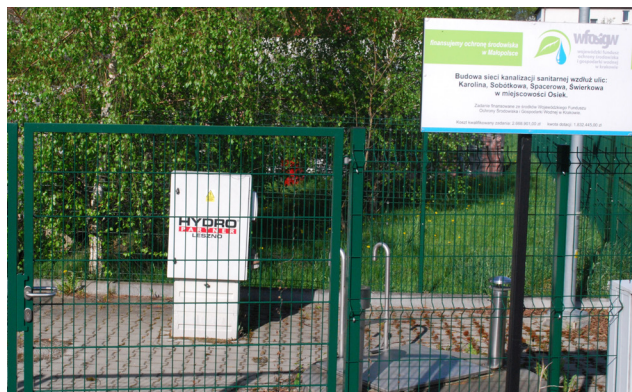
Pompownia kanalizacji przy ul. Świerkowej
